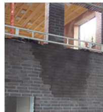
Resultatet af en utilstrækkelig afdækning i forbindelse med en murkrone.
