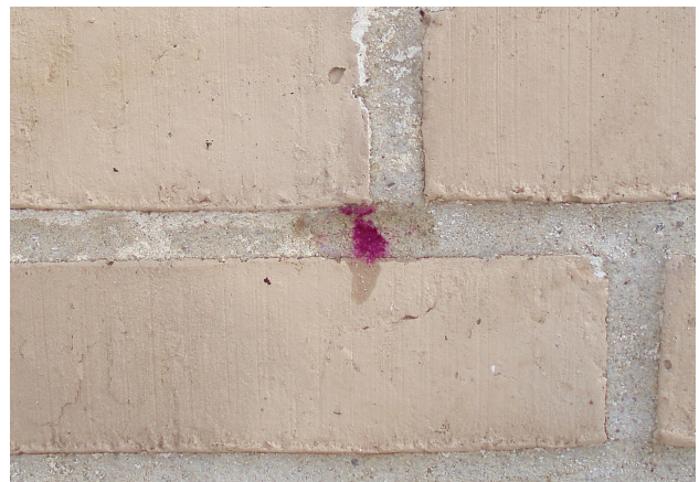
Forkert afsyring om vinteren. Mørtelfugerne virker "våde"/hygroskopiske. Rødfarvningen ved afsyringen indikerer, at mørtlens kalkdel ikke er fuldstændigt karbonatiseret/afhærdnet.
