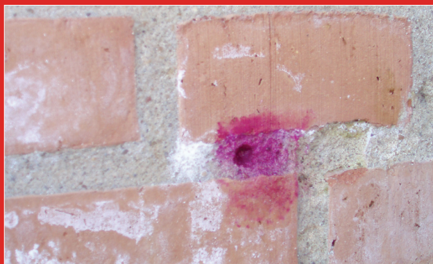
Frostafskalninger i mørtelfuger: Vandindholdet er stadig over 7 vægt-% (rødfarvning ved påføring af phenolphthalein).
