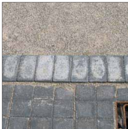
Kraftige kalkudfældninger på sorte sten. Er sådanne udfældninger tilstede ved lægningen skal leverandøren kontaktes for at aftale det videre forløb.
