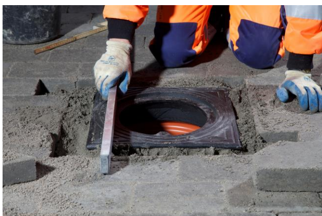
Den nye karm trykkes ned i betonen så den er i niveau med belægningsstenene.
