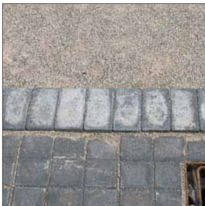
Kraftige kalkudfældninger på sorte sten. Er sådanne udfældninger tilstede ved lægningen skal leverandøren kontaktes for at aftale det videre forløb.
