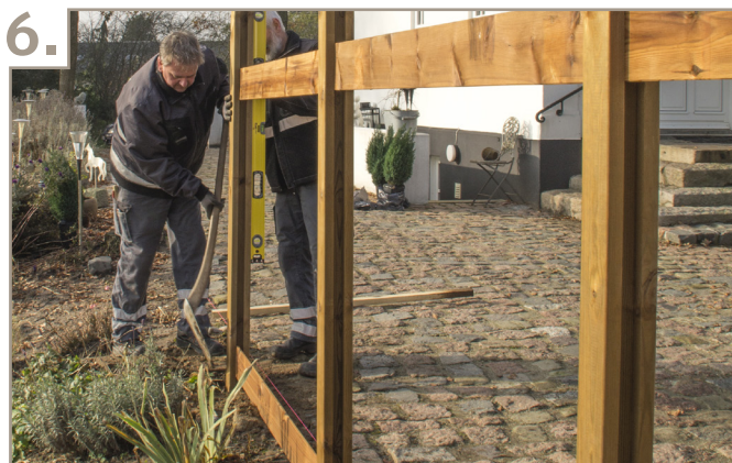
6. Nu fortsætter du med resten af stolperne på samme måde indtil de alle er på plads med profiler i bund og top til at holde det hele sammen, før de mellemste profiler monteres.
