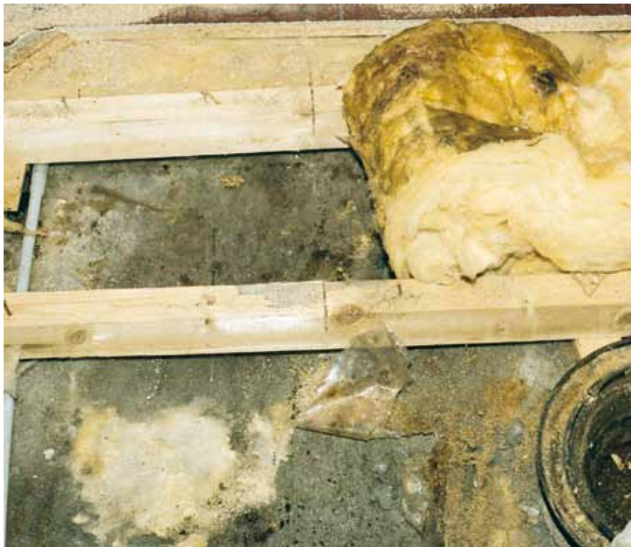
Fugt fra undergrunden er trængt igennem betonen/plastfolien og har ført til mugdannelse.
