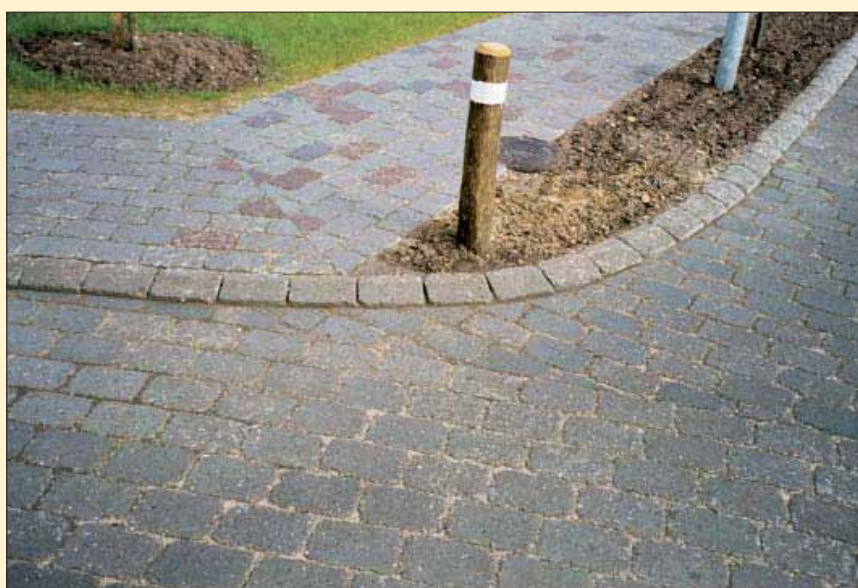
I denne belægning har der været gravet op for at reparere telekabler. Ved en omhyggelig og korrekt retablering kan det gøres uden ar i belægningen.
