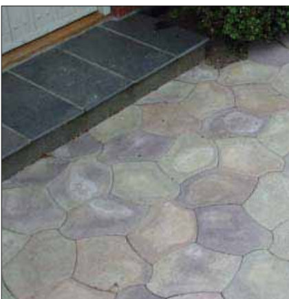
Kalkudfældninger er almindelige, og forsvinder igen i løbet af 1-2 år.
