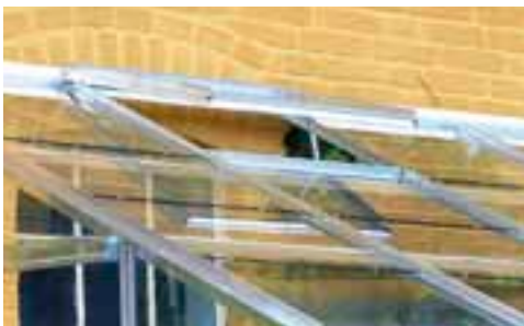
Vinduer til ventilation.
