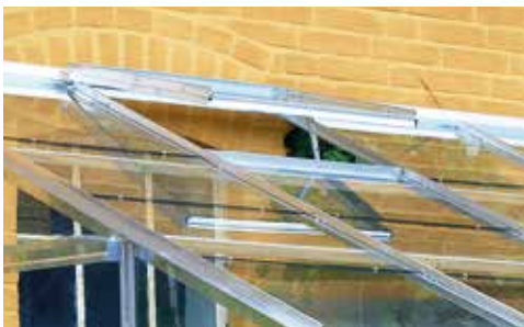
Vinduer til ventilation.
